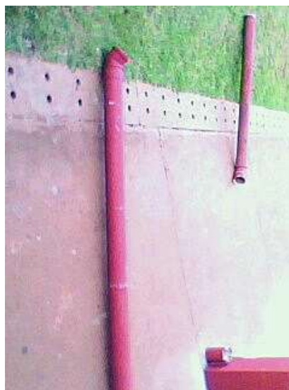
Figura 3: Condutores de água das calhas destruídas
