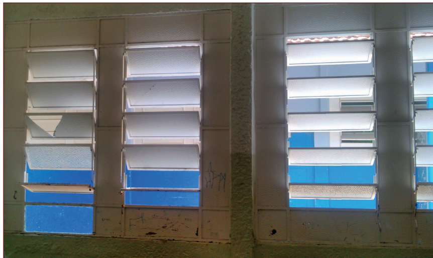
Figura 8. Vidros das janelas da sala quebrados 1 .
