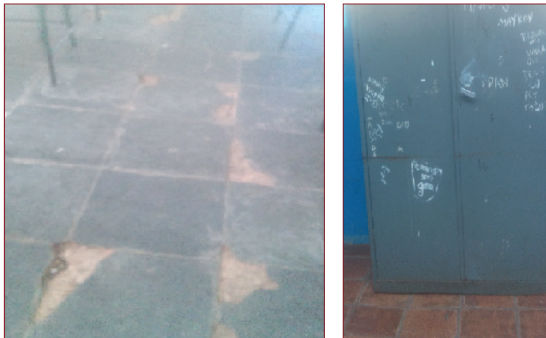
Figura 6. Piso da sala de aula quebrado e armário pichado 1 .
