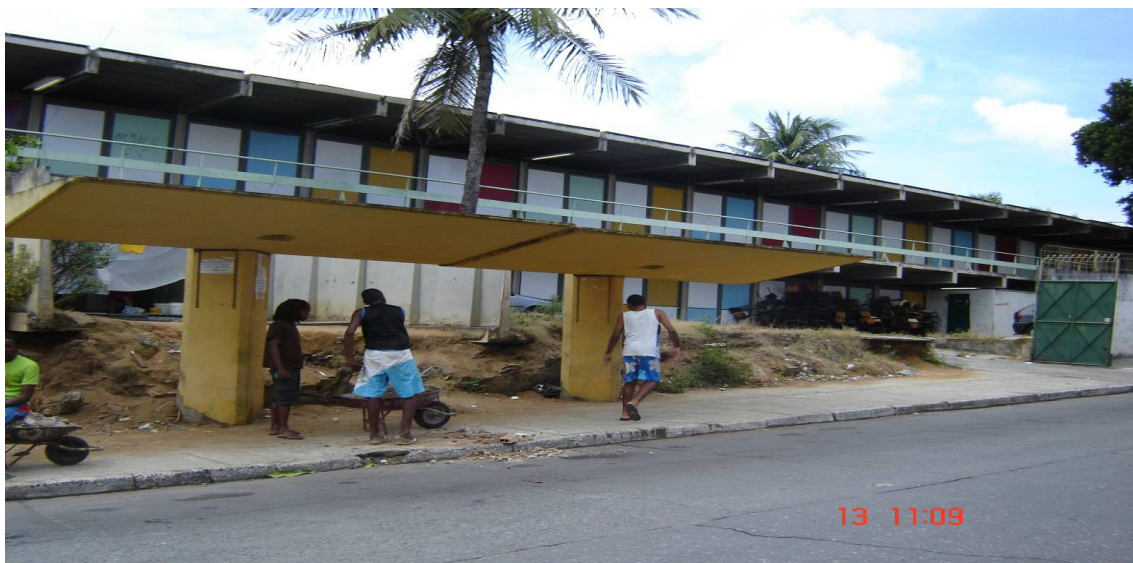
Foto 3: Vista lateral da escola: local onde o muro da escola caiu. Na frente, um ponto de ônibus e, ao fundo, o prédio da escola.
