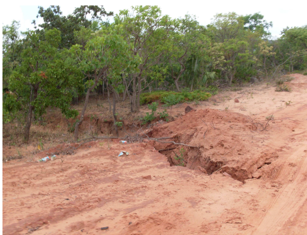
Foto 21: fenda na estrada de chão que leva à escola – foi reformada pelos moradores da comunidade Fonte: Arquivo da pesquisadora.
