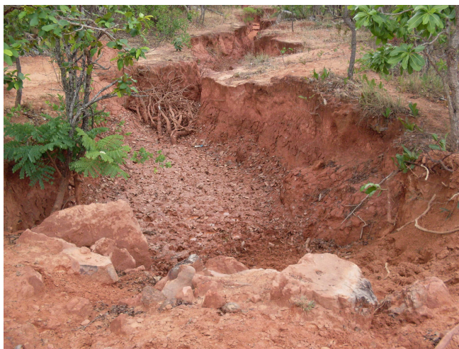
Foto 20: estrada de chão no meio rural danificada pelas chuvas. Fonte: Arquivo da pesquisadora.
