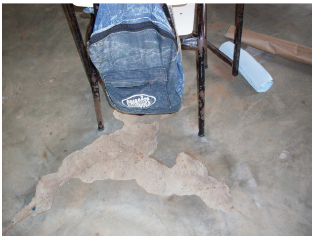
Foto 11: Chão da sala de aula – precisando de reformas. Fonte: Arquivo da pesquisadora.
