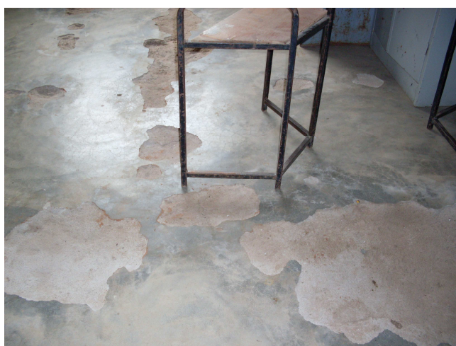
Foto 12: Chão da sala de aula – péssimo estado. Fonte: Arquivo da pesquisadora.
