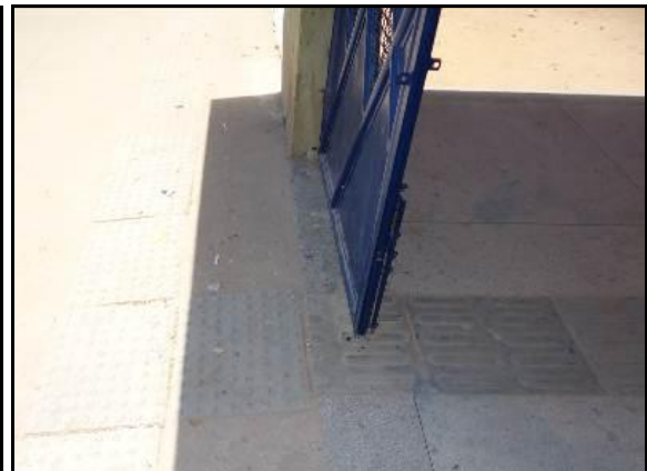
Figura 4.6 – Obstrução do piso tátil
