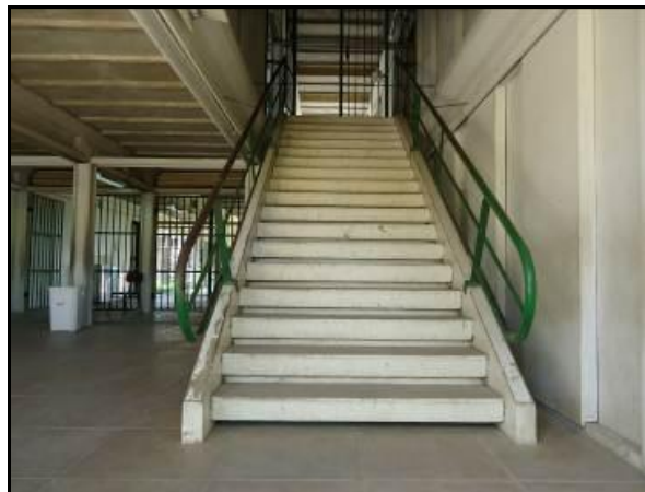
Figura 4.56 – Ausência de sinalização tátil na escada
