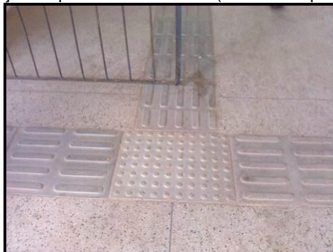
Figura 5.5 – Obstrução do piso tátil no corredor (Ponto C na planta baixa das rotas).
