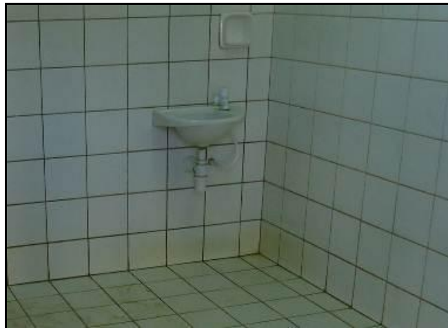
Figura 4.15 – Ausência de contraste no banheiro
