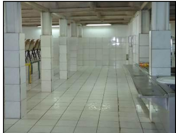
Figura 4.62 – Ausência de piso alerta nos pilares
