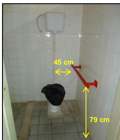
Figura 4.117 – Vaso sanitário feminino
