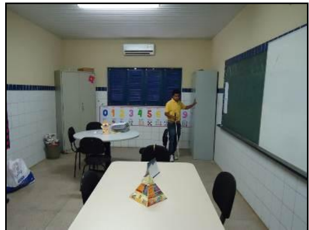
Figura 4.14 – Ausência de contraste entre piso e parede na SRM
