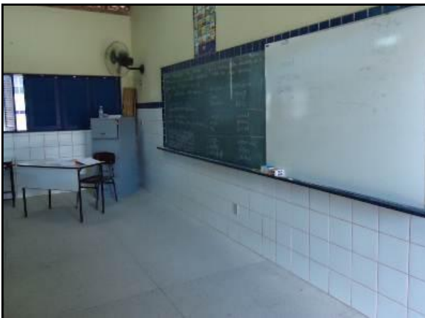
Figura 4.13 – Ausência de contraste entre piso e parede na sala de aula
