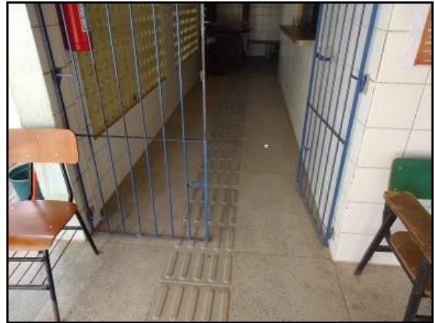
Figura 4.10 – Obstrução piso tátil
