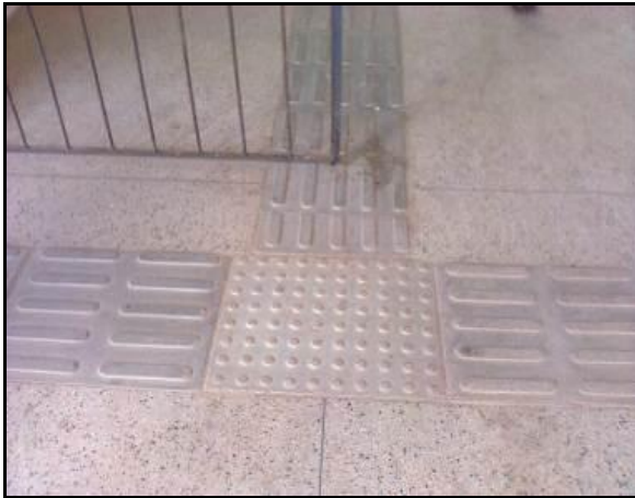
Figura 4.9 – Ausência de contraste
