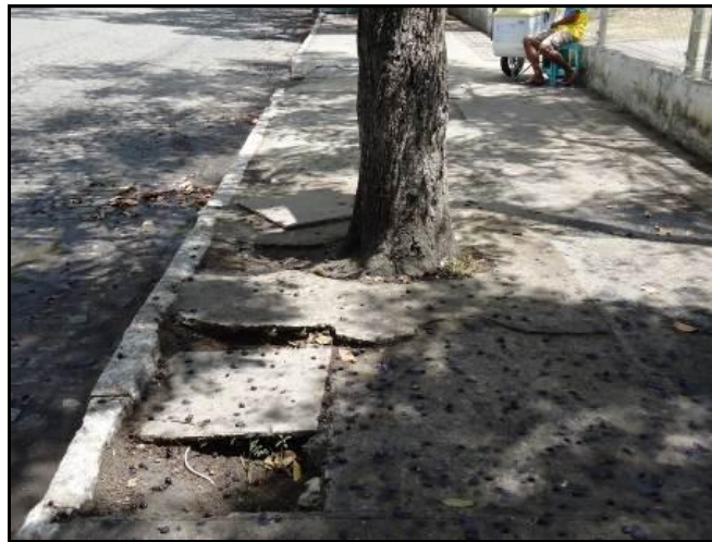
Figura 4.66 – Obstáculos na calçada
