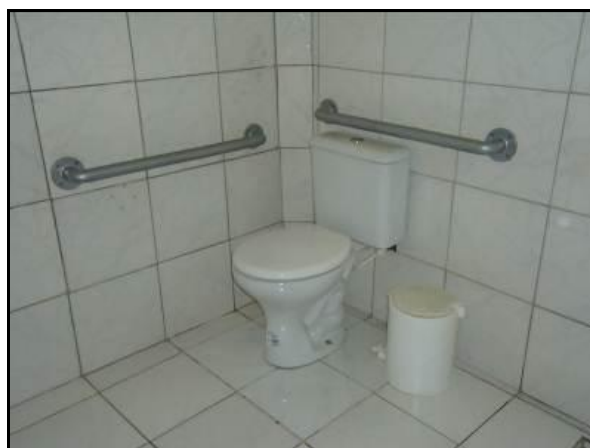
Figura 4.85 – Barra de apoio do vaso sanitário
